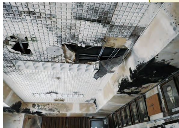
リノベーション前の校舎内。雨漏りで天井が落ちていた
